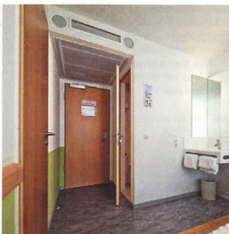
Ein niedriger Geräuschpegel in den Räumen wurde durch einen extra installierten bauseitigen Filter in den Deckeneinbaugeräten mit Kanalanschluss erzielt.
